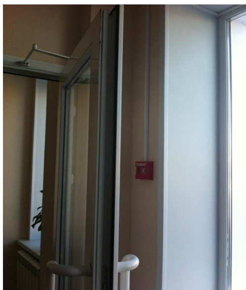
Рисунок 35. Ручной пожарный извещатель установлен с нарушением
