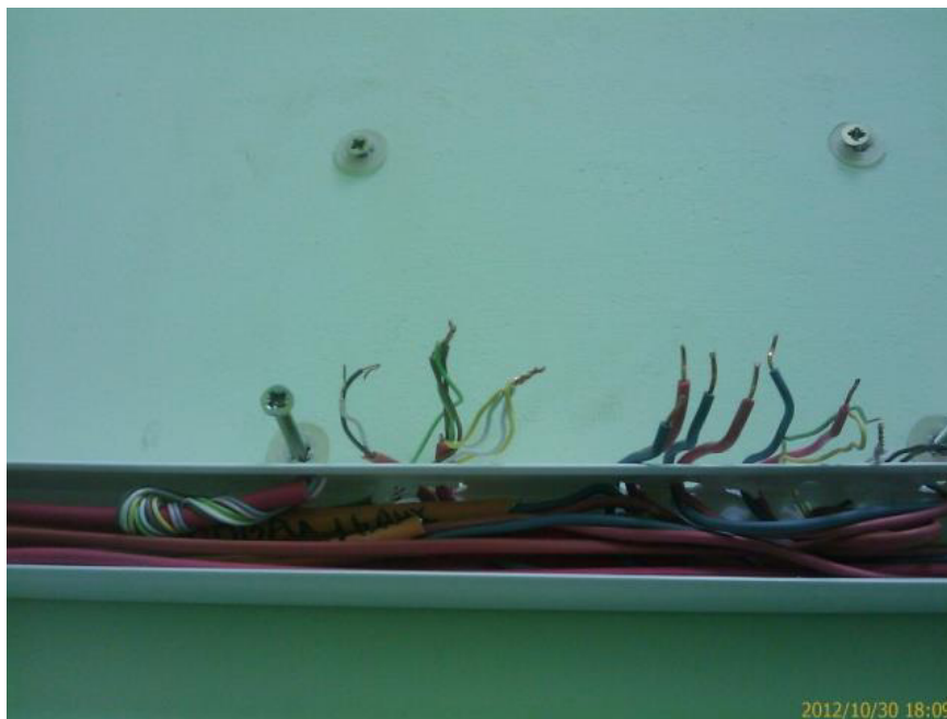
Рисунок 32. Неправильное соединение проводов
