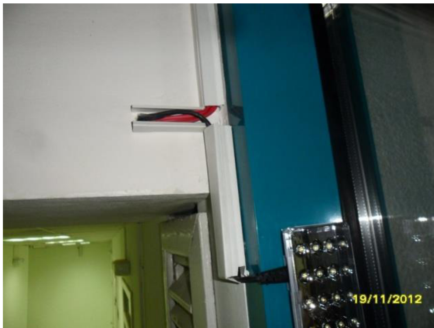
Рисунок 34. Нарушены правила совместной прокладки шлейфов
