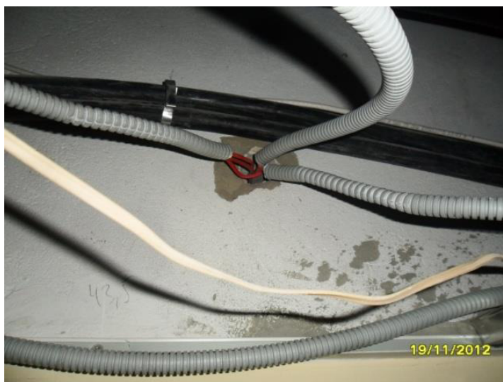
Рисунок 30. Неправильная заделка зазоров при прокладке кабелей
