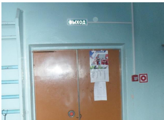
Рисунок 26. Отсутствие защиты извещателя. В спортивных залах элементы АПС и СОУЭ должны быть надежно защищены от случайного повреждения.
