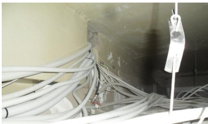
Рисунок 18. Неправильное размещение кабельных линий в пространстве за подвесным потолком
