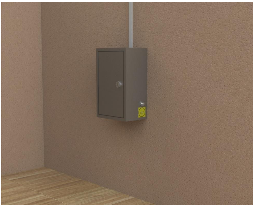
Рисунок 28. Отсутствует защитное заземление
